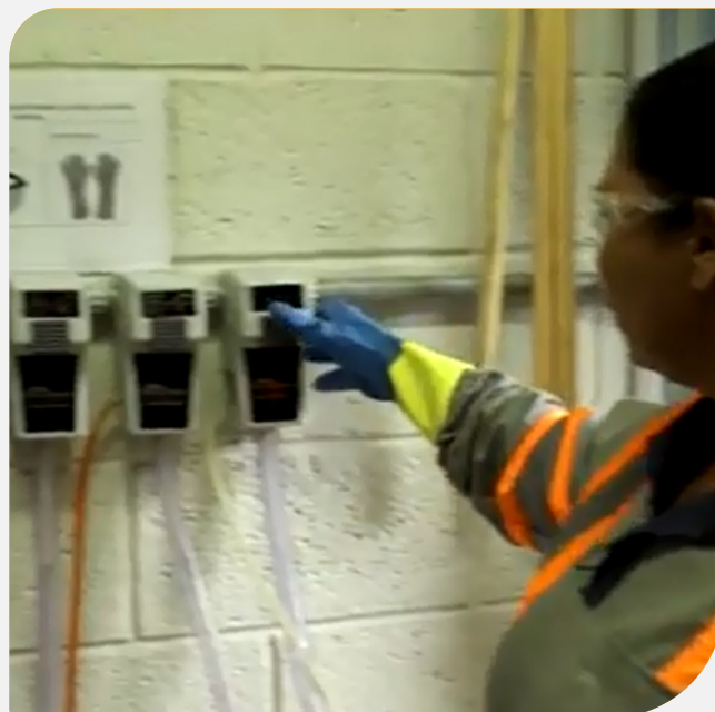
Diluidor de Produtos de Limpeza na unidade LafargeHolcim Pedro Leopoldo
